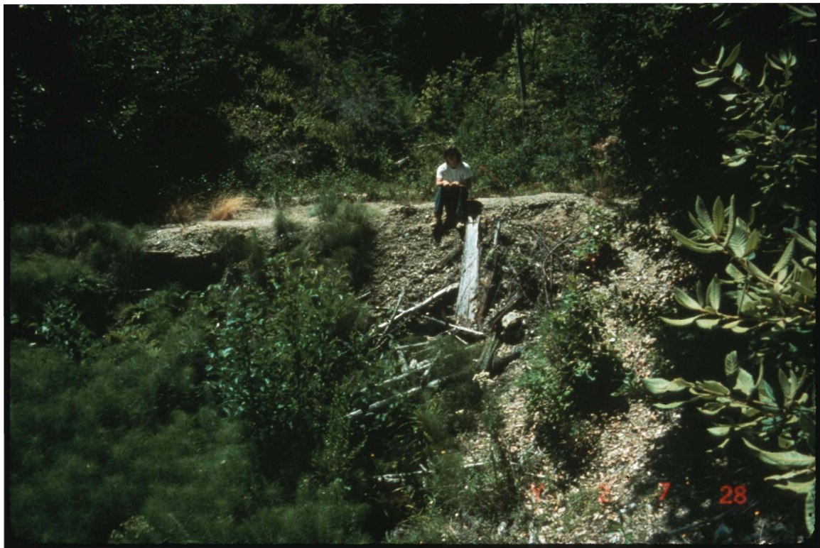
Unit: 81-5 1-A 7/28/81 PP#3B OS @ Sta 38-00
