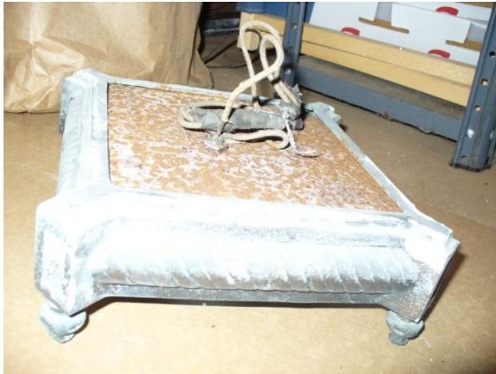
Photo #34 – Pendant Light Fixture
