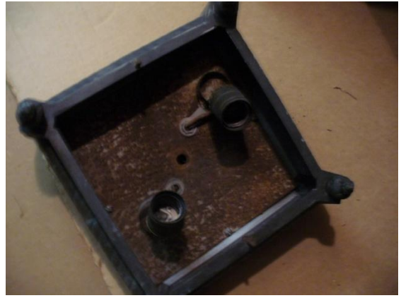
Photo #35 – Pendant Light Fixture
