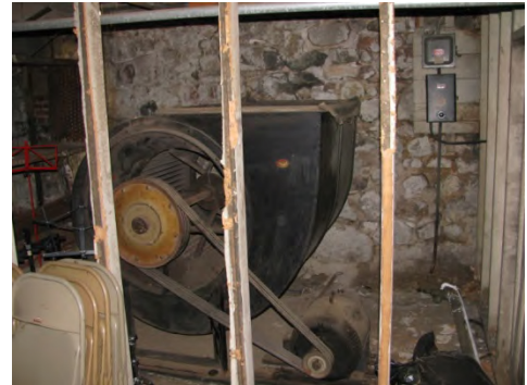
Existing Auditorium Supply Fan
