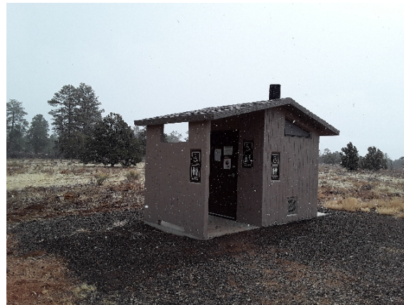
2021_ELMA_238191_El Calderon Bathroom_Front.jpg
